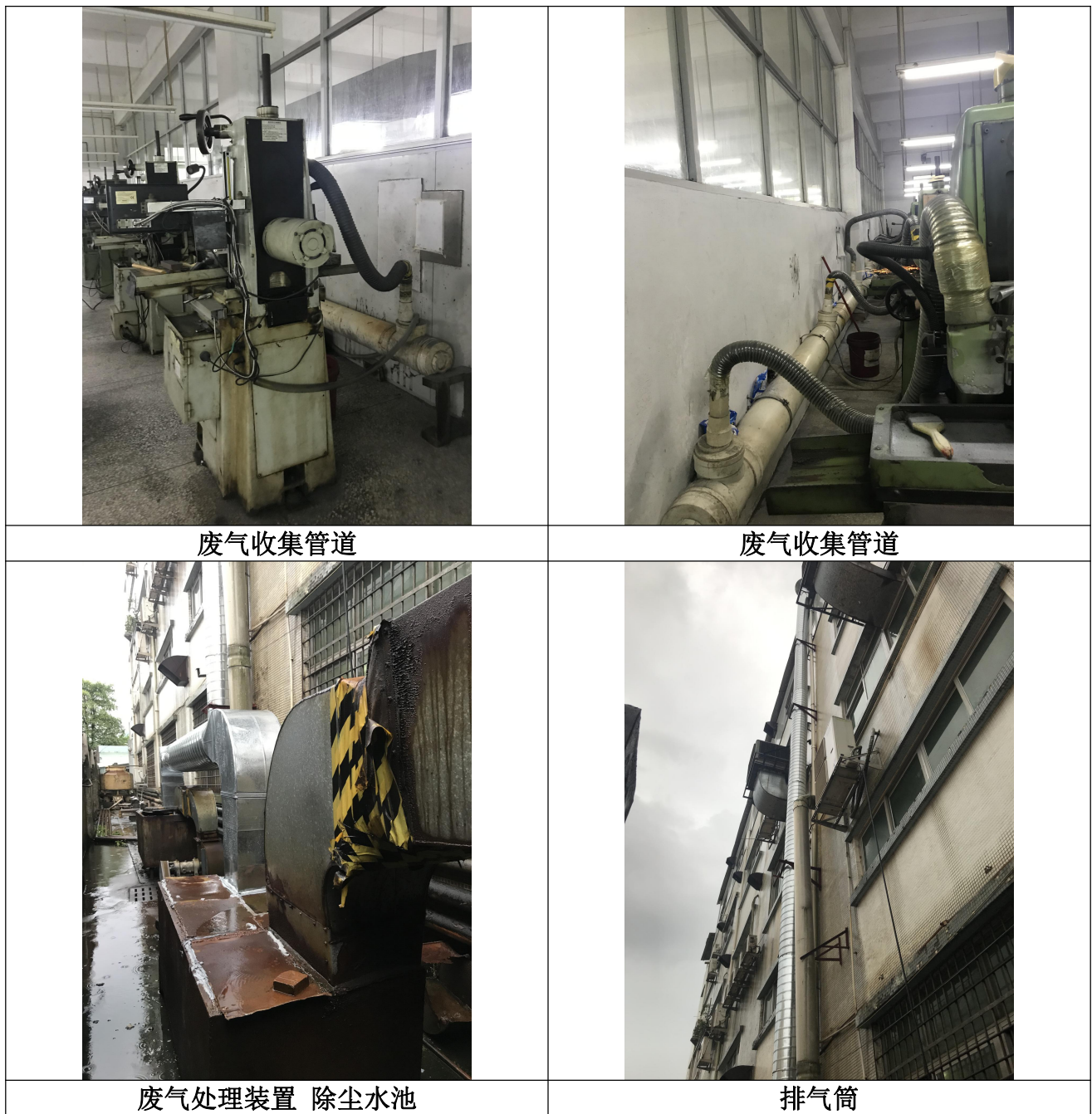
图4-1 废气收集处理装置
